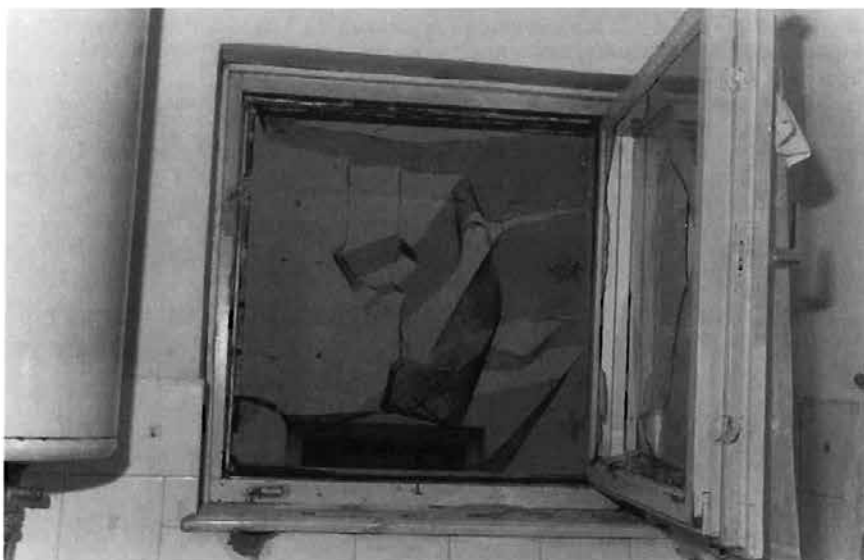
Слика 65 Оштећења на прозору купатила
