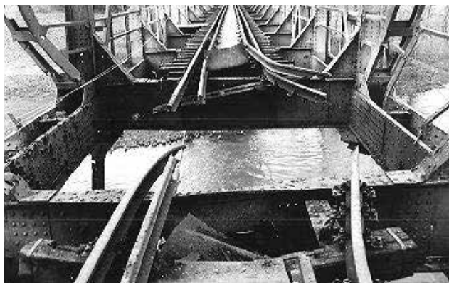
Слика 5. Оштећено средње поље железничког моста Шарпељ. 43
